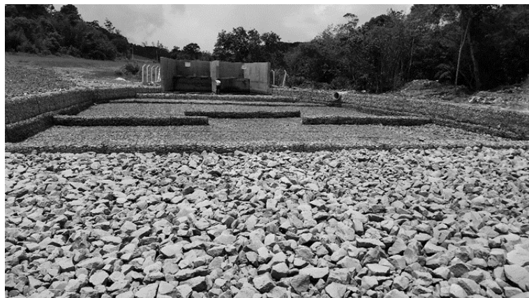
Figura 2 - Caixa de dissipação de energia de adutora realizada em gabiões tipo caixa e colchão. Fonte: Giudice et al. (2015).
